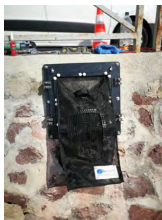
Photo d'un dispositif récupération des macrodéchets en sortie d'exutoires pluviales avant rejet dans l'eau (Source : Photo Commune de Mandelieu La Napoule, Exutoire existant sur plage de Mandelieu)
